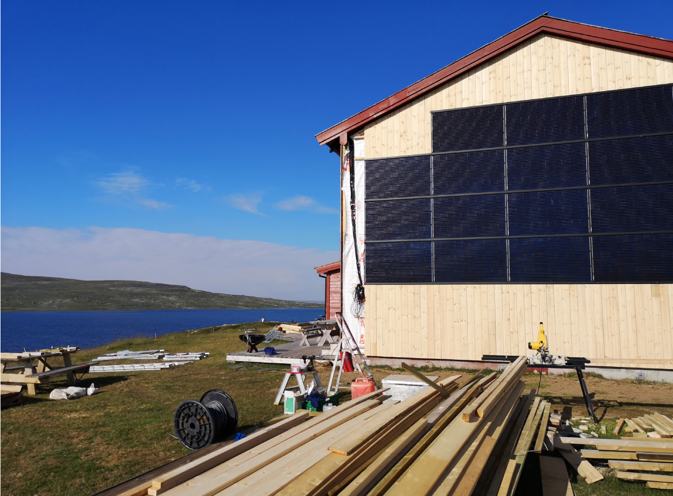
Solpaneler felt inn i gavelveggen. Panelet skal etterhvert få en naturlig gråfarge og ramme inn panelene. Foto: Johan Fegri
